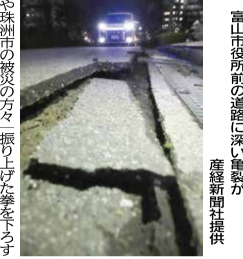
富山市役所前の道路に深い亀裂が産経新聞社提供
